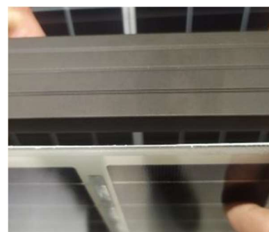
rys.6 Brak silikonu lub kleju łączącego ramę z elementami wewnętrznymi
