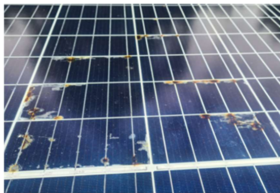
rys.2 Widoczne punktowe wypalenia
